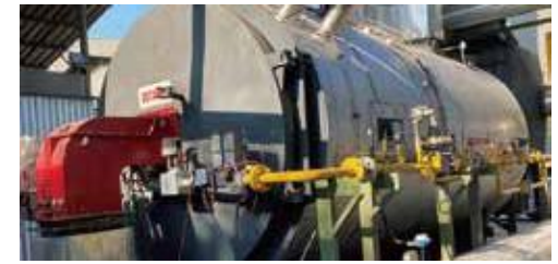
貫流ボイラー (インドネシア) DIC
