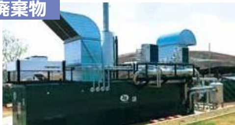
メタンガス回収発電 (メキシコ) NTT データ経営研究所
