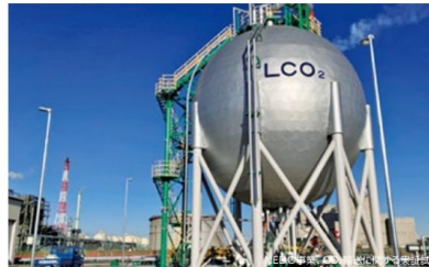
■ CCS(実証設備)
