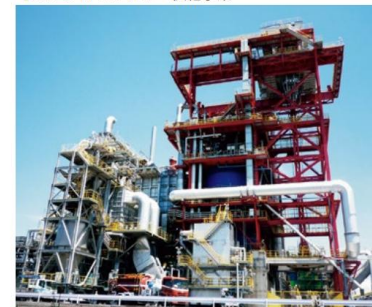
■ コークス乾式消火設備(CDQ)
