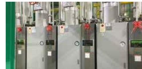
貫流ボイラー (インドネシア) DIC
